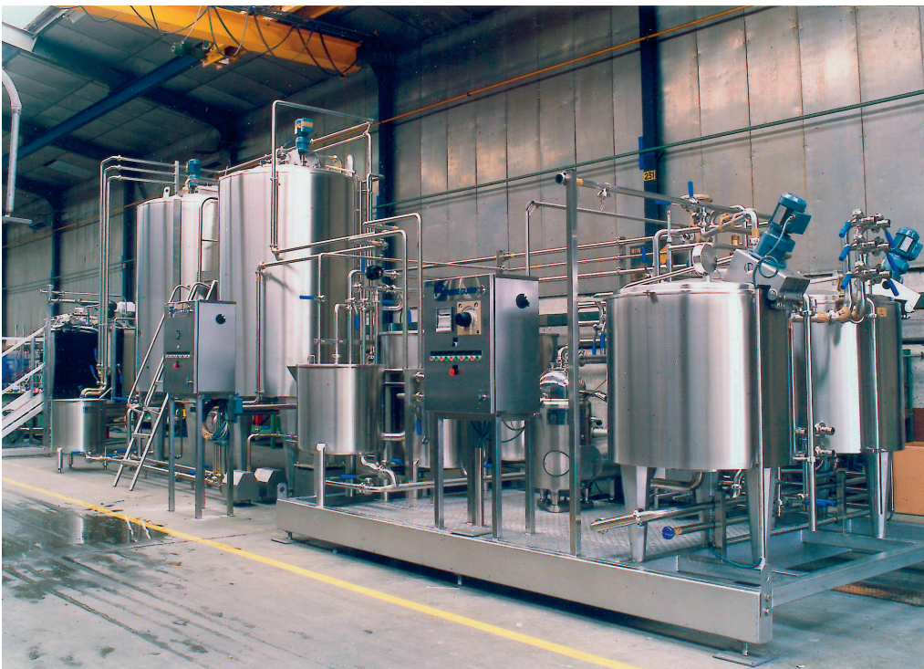
Zdjęcie 9: Instalacja pasteryzacji mleka
