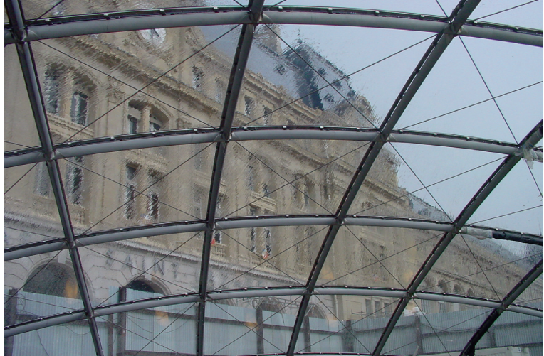
Zdjęcie 7: Konstrukcja ze stali i szkła „La lentille de la cour de Rome” - Paryż (F)
