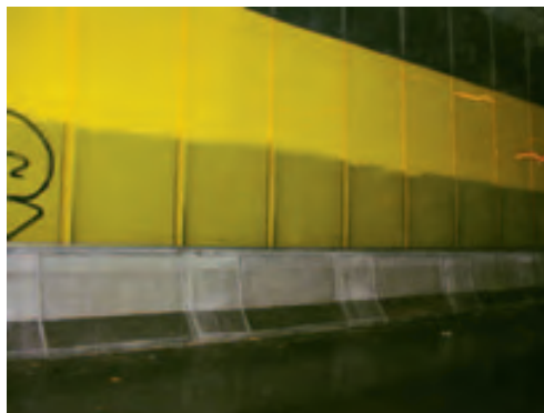
Czyszczenie ścian bocznych tunelu nie ujawniło korozji powierzchni, mimo bardzo niekorzystnych warunków eksploatacji. Zdjęcie: Centro Inox, Mediolan (Włochy)
