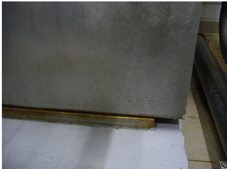
Rys. 9. Między przedstawionymi dwoma elementami, cyrkulacja oparów w środowisku pracy jest niedostateczna: zaobserwowano korozję w rowku między elementami, nie uwzględniono warunków panujących w danym pomieszczeniu i środowiska pracy elementów
