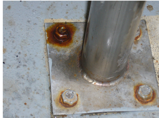
Rys. 3. Korozja galwaniczna stalowej śruby mocującej element ze stali nierdzewnej
