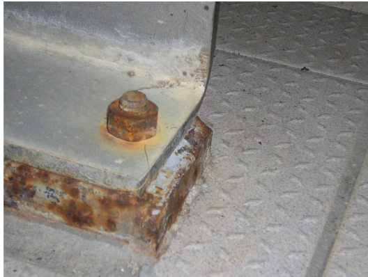
Rys. 2. Połączenie między stalową podporą, a nierdzewną śrubą bez żadnej dodatkowej izolacji między elementami
