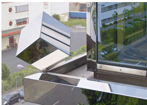
Okładzina elewacji z wykończeniem po wyźarzeniu jasnym przed i po czyszczeniu: standardowe operacje konserwacyjne przywracają wygląd silnie odbłaskowej powierzchni do jej początkowego połysku. Zdjęcie: Christian Pohl GmbH, Kolonia (D)
