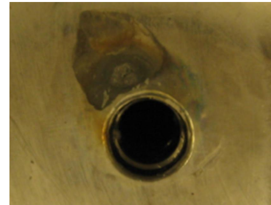
Korozja przy odpływie zbiornika
